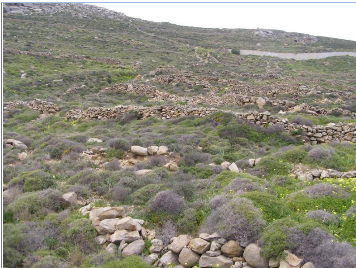
Φ4: Άποψη ξερολιθιών στο ακίνητο, με εμφανείς φθορές. Η λήψη έχει προσανατολισμό Α→Δ
