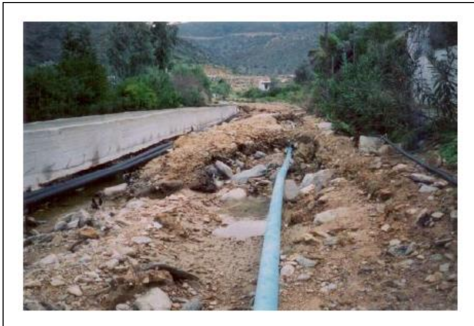
Εικ.22: Διάβρωση στην οδό που ενώνει το φράγμα Μυλοποτάμου με την παραλία.
