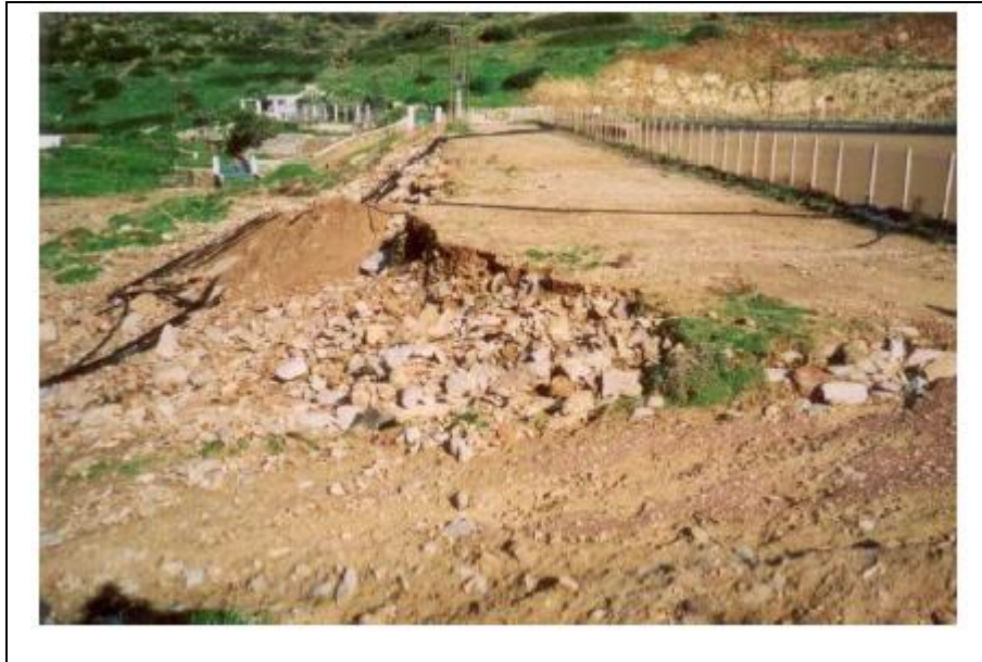
Εικ.21: Διαβρωμένη στέψη φράγματος Μυλοπότα.
